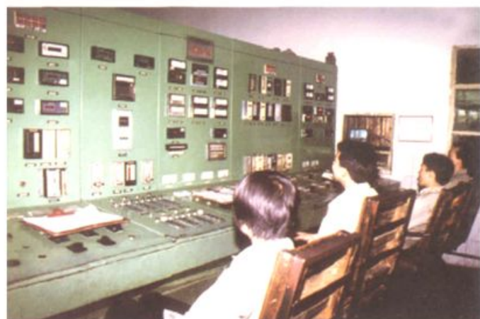
热电分厂控制室
