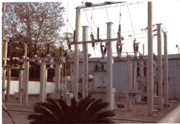
▲ 冈上供电所高压变电设施
