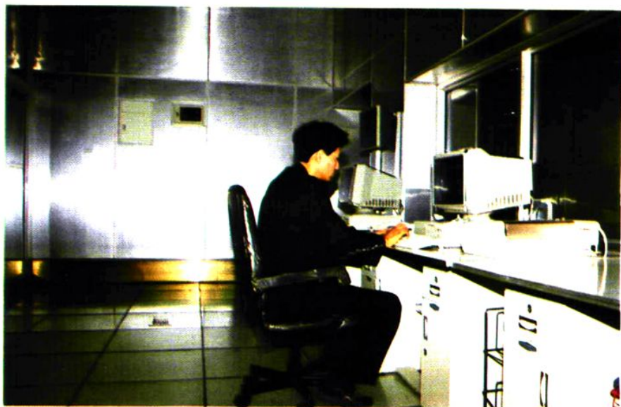
▷ 程控机房值班室
