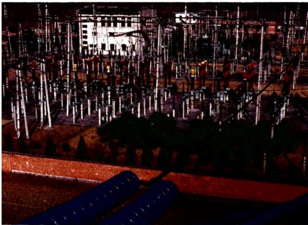
蚌埠东郊变电所
