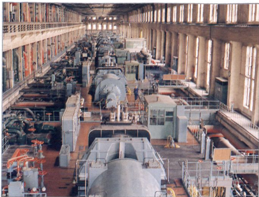
甘肃省建行支持建设的西固热电厂
