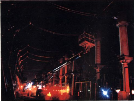
承建的500kV南宁变电站工程（2001）
