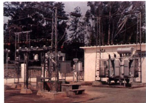
援建的布隆迪共和国布琼布拉变电站（1978）
