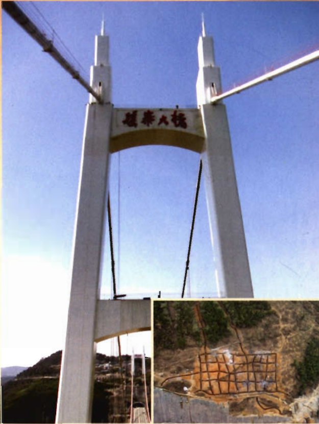
州防雷中心为矮寨大桥安装的避雷针（右下为地网）
