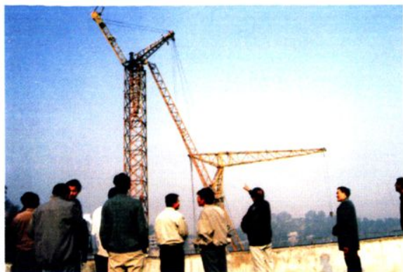
1998年12月21日，市劳动安全监察部门派员在公路处建筑工地塔吊臂断坠事故现场调查
