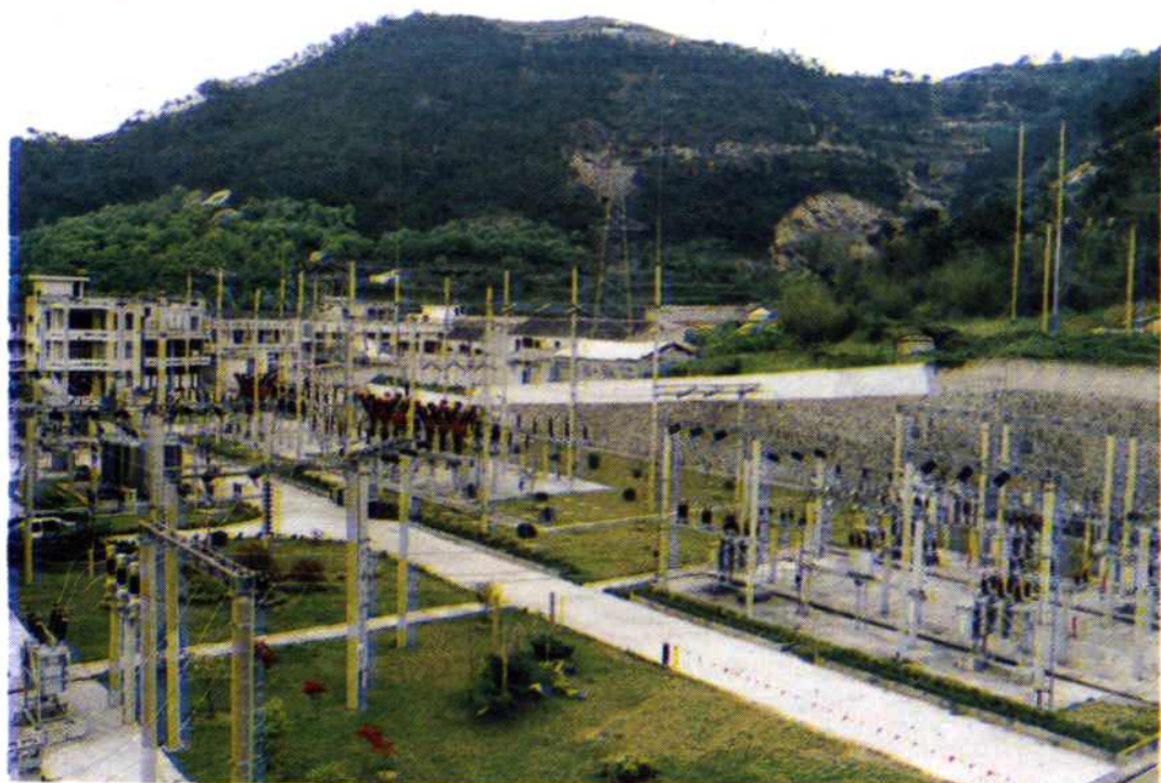
110 千伏玉环变电所
