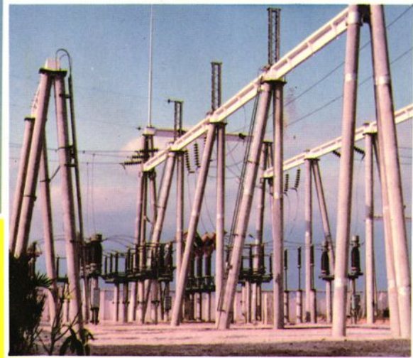
▼ 110 千伏输变电站
