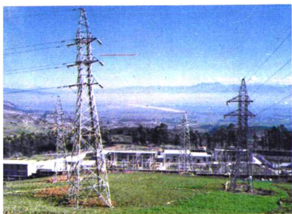
辛街 110KV 变电站
