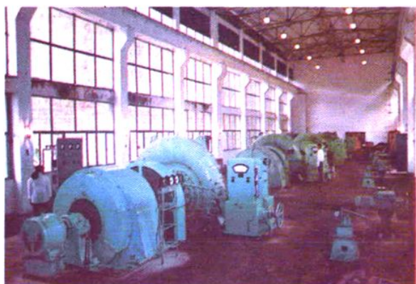
腾冲县曲石电站机房
