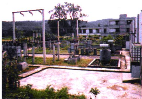
龙陵县勐糯变电站
