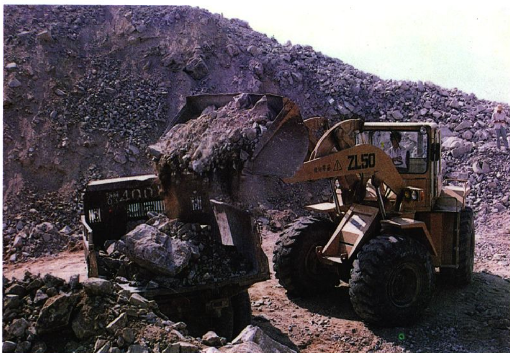
一支拥有300多万元机械设备的场土方工程队正在三亚国际凤凰飞机场施工。
