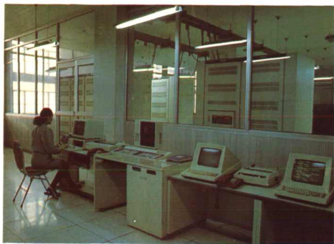
兰州市引进的万门程控电话交换系统
