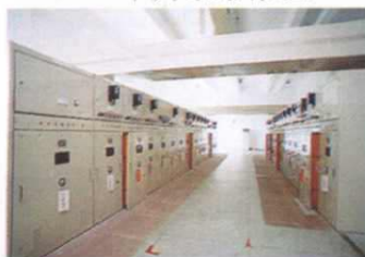
35千伏专线开关室
