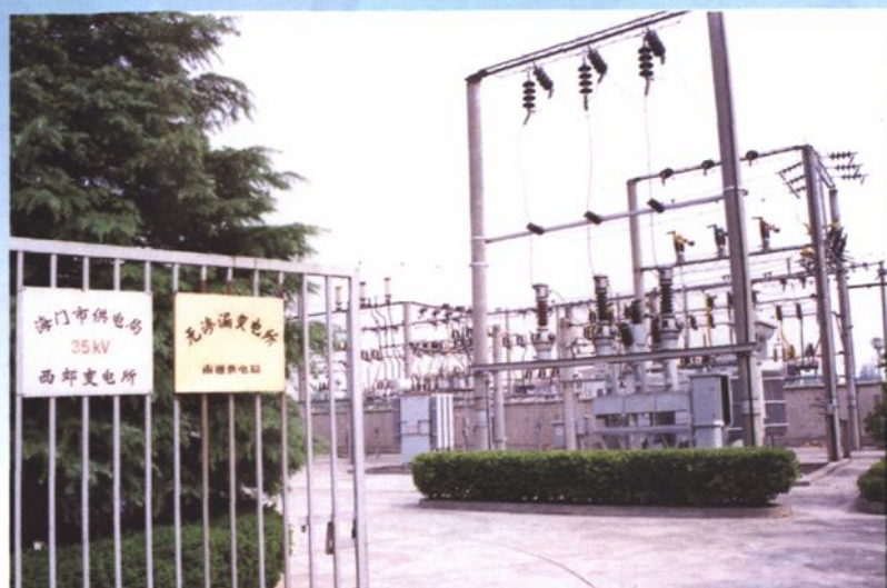
江苏省农村小型化 变电所试点工程——35 千伏西郊变电所
