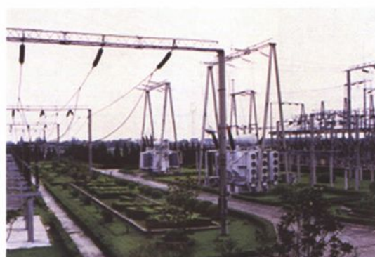
海门市第一座220千伏变电所——220千伏 常乐变电所
