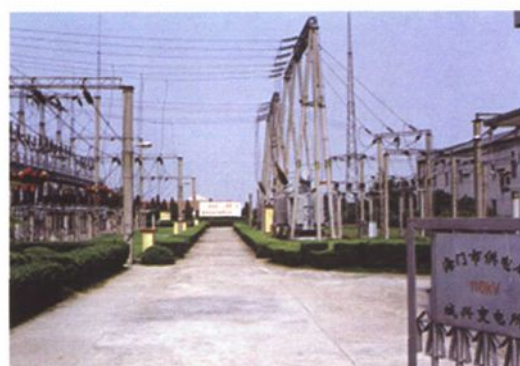
110千伏城兴变电所
