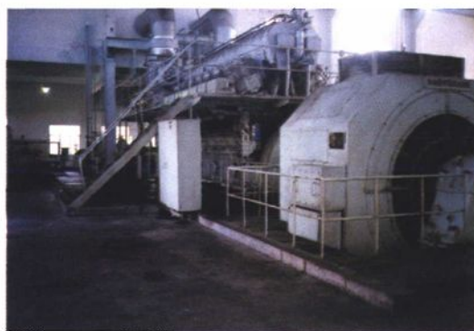
南通海宁电力有限公司柴油发电机组
