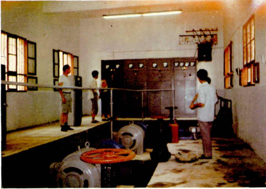
张卜抽水站机房
