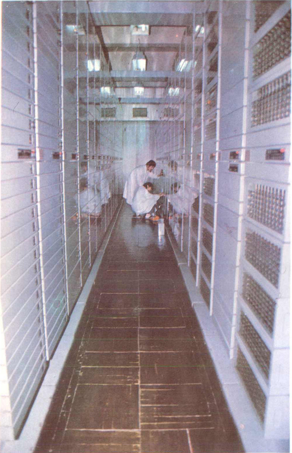
厂前纵横制自动电话机房
