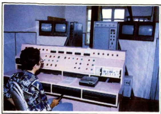
玉山县教育电视台机房
