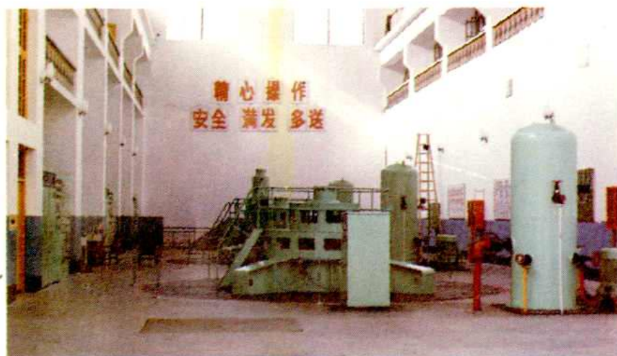
▲ 三角滩水电站机房
