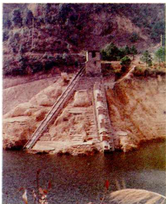
▲ 五龙溪水库悬臂式铸铁闸门放水管
