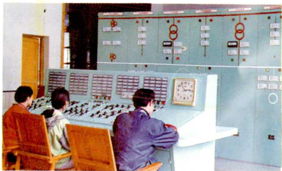
▲ 三角滩电站机房工作人员在精心操作
