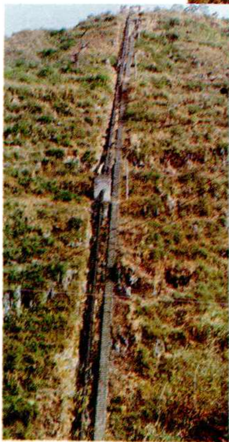
◀ 仙人桥电站高水头压力管
