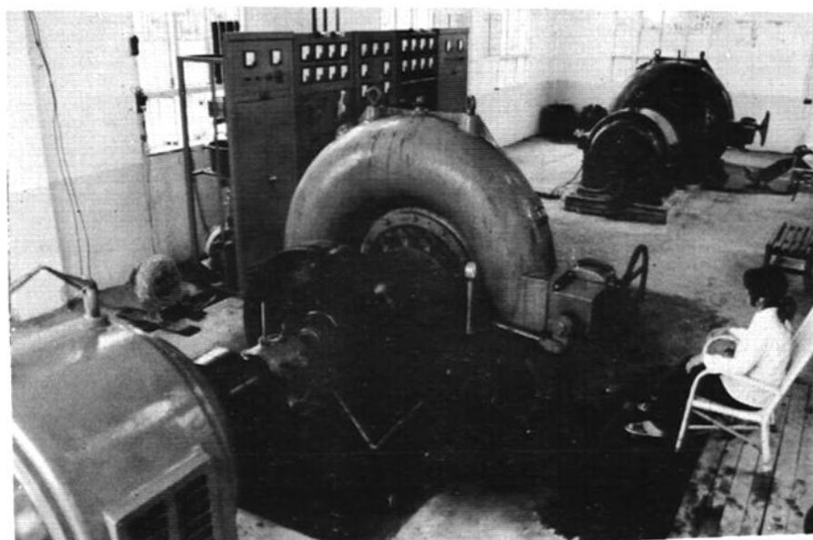
凤仙桥水库坝后电站
