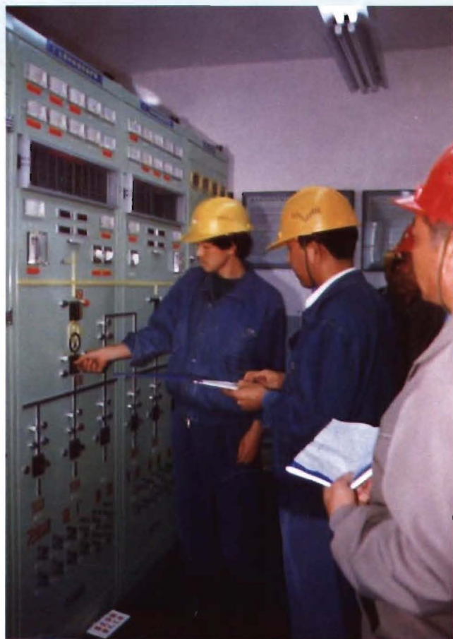
1995年，35千伏桑梓变电站设 备管理人员工作场景
