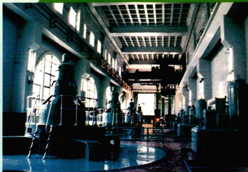
▶ 长寿发电厂狮子滩水电站发电机房
