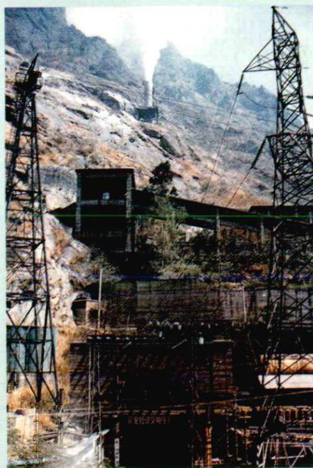
▲ 洞内发电厂—新庄发电厂外景 (总装机容量 10 万千瓦)
