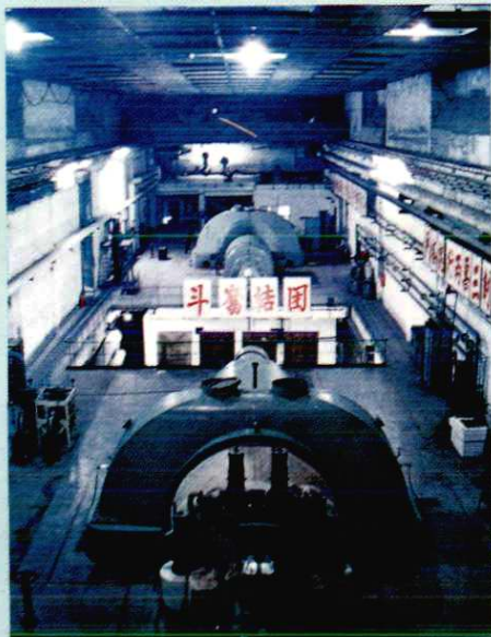
▲ 五通桥发电厂洞内机组
