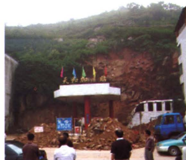
2006年6月20日，贵州省兴义市天和加油站崩塌场景
