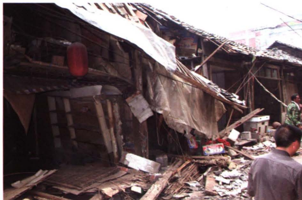
2006年7月22日，云南省昭通市盐津县5.1级地震之后，石门村土木房屋发生成片倾斜
