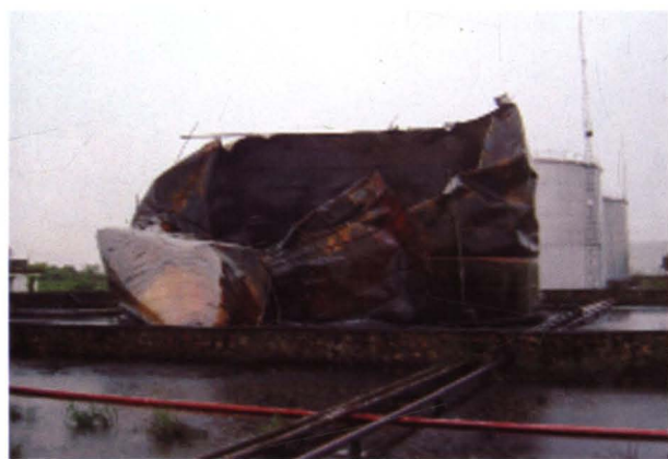
2006年7月15日，广东惠州东江发电厂1号油罐遭雷击
