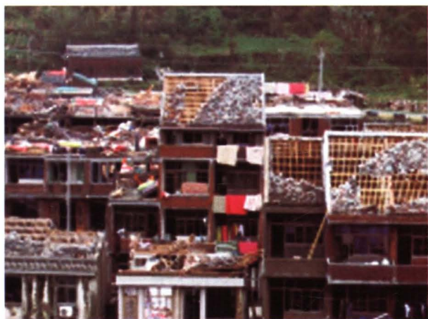
2006年8月10日，浙江省苍南县遭受“桑美”台风袭击，建筑物被损坏
