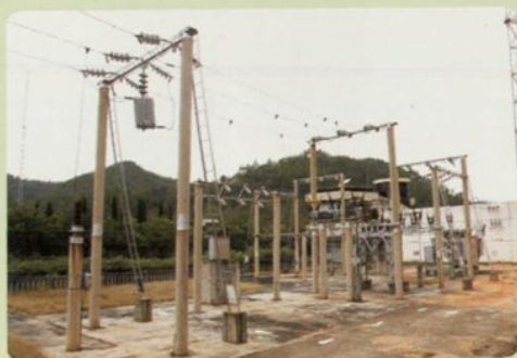
35千伏长演变电站
