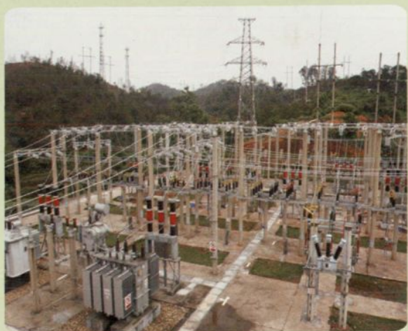
35千伏梅林变电站
