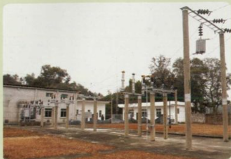
35千伏南塘变电站
