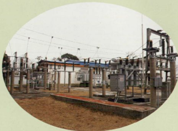
35千伏江口变电站
