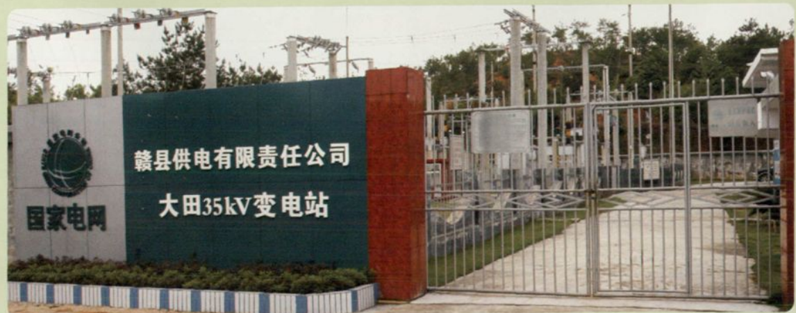
35千伏大田变电站
