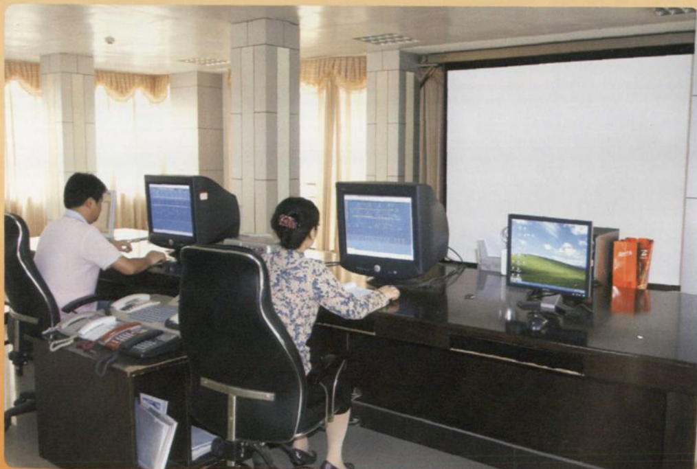
电力调度中心
