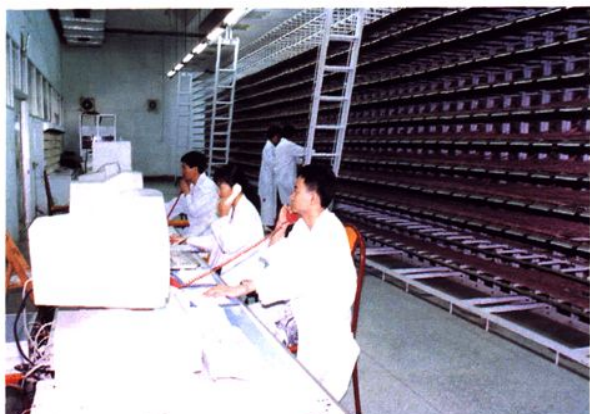
90年代的F-150程控交换机测量室（位于电信枢纽大楼）。
