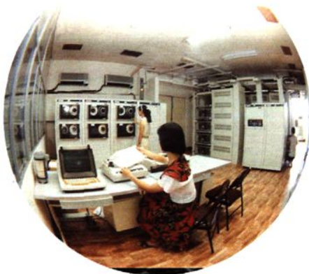
1983年开通的F-150长途程控交换机房。
