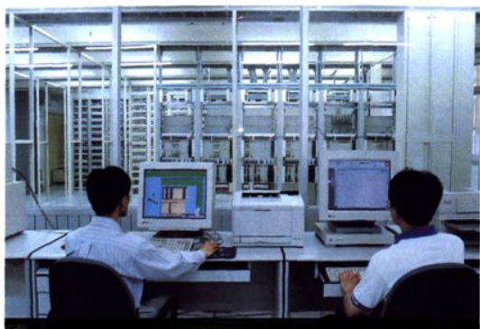
福州本地网传输SDH网管中心。
