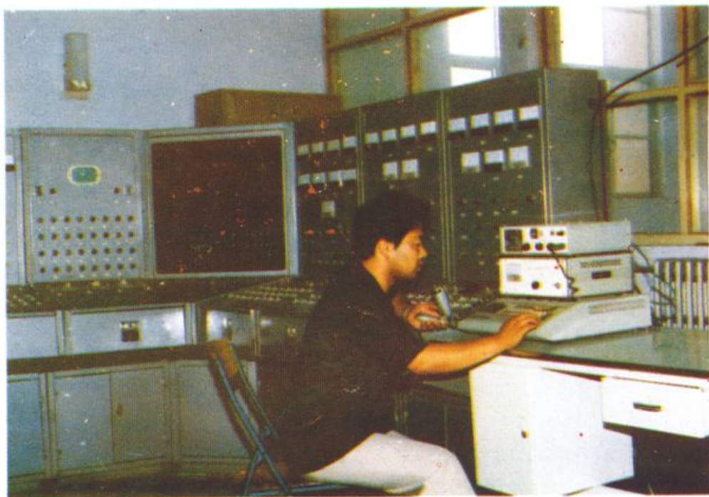
三 水 厂 控 制 室
