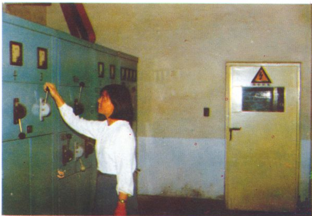
四水厂配电室
