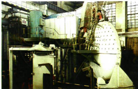
抚钢股份公司第三炼钢厂3、6吨真空感应炉
