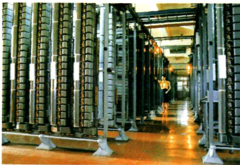
二分局步进制 市话交换机房
