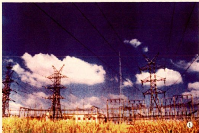
1. 1994 年，220 千伏六合变电站远景
