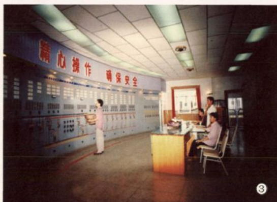
3. 220 千伏六合变电站主控制室
