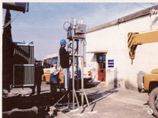
5. 2002 年 11 月，六合供电公司 35 千伏四合 变电站综合自动化改造
