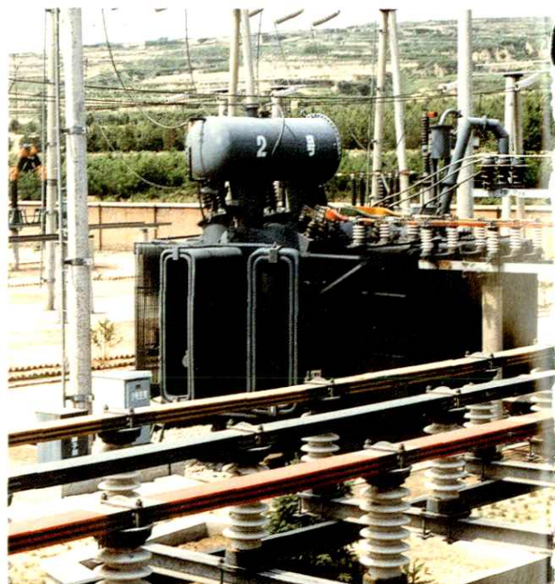
110 千伏大井峪变电站一角
