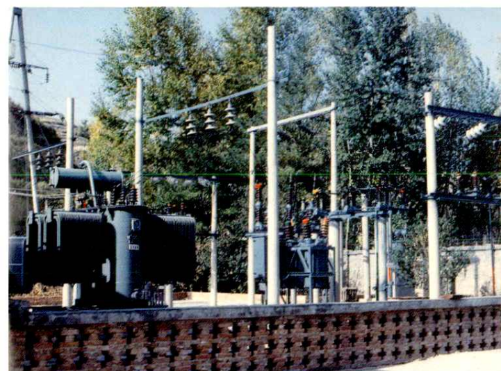
35 千伏变频变电站
