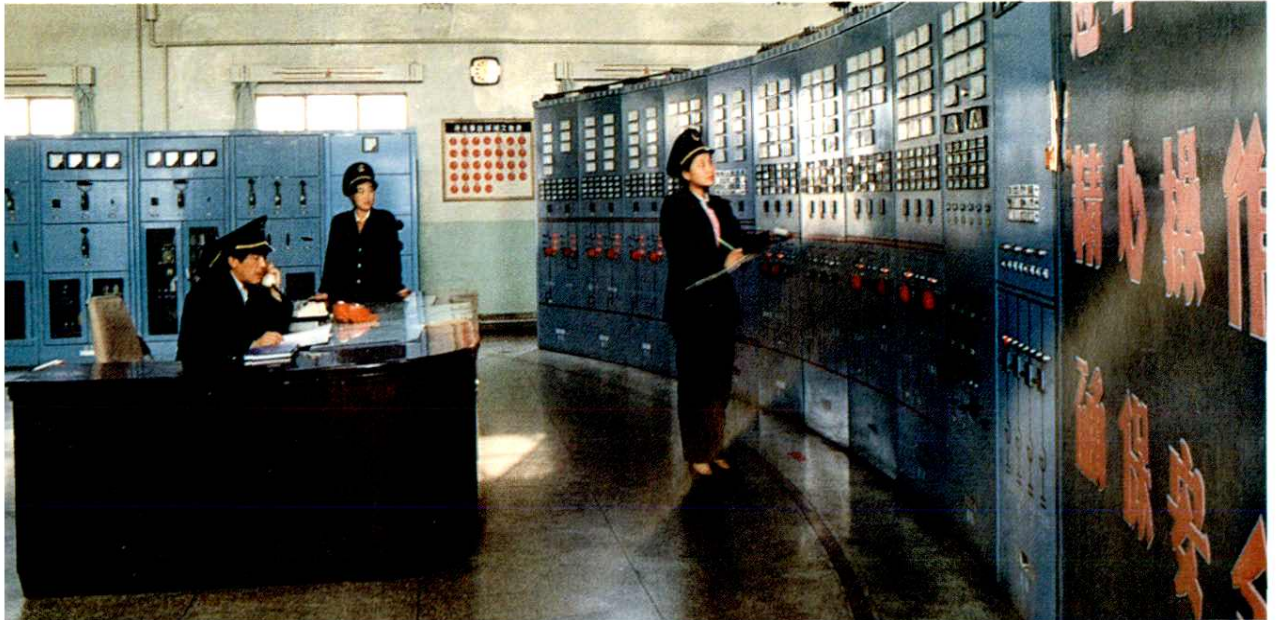
220 千伏新店变电站主控室
