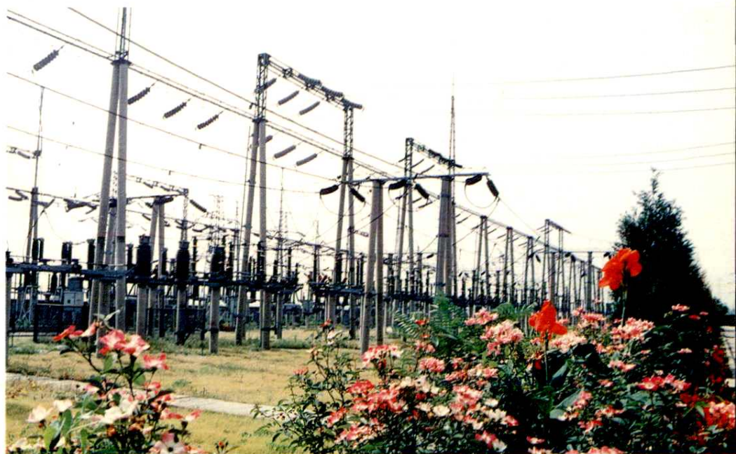
220 千伏南社变电站一角
