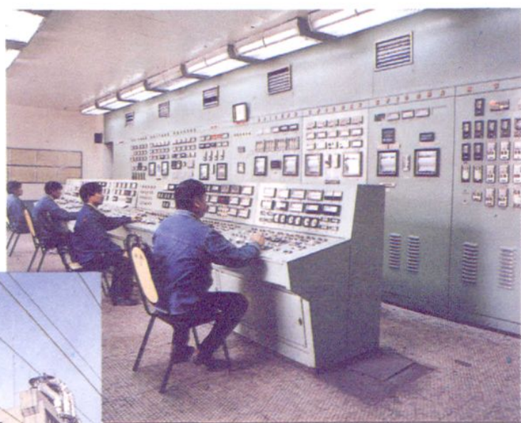
9号机炉集中控制室
