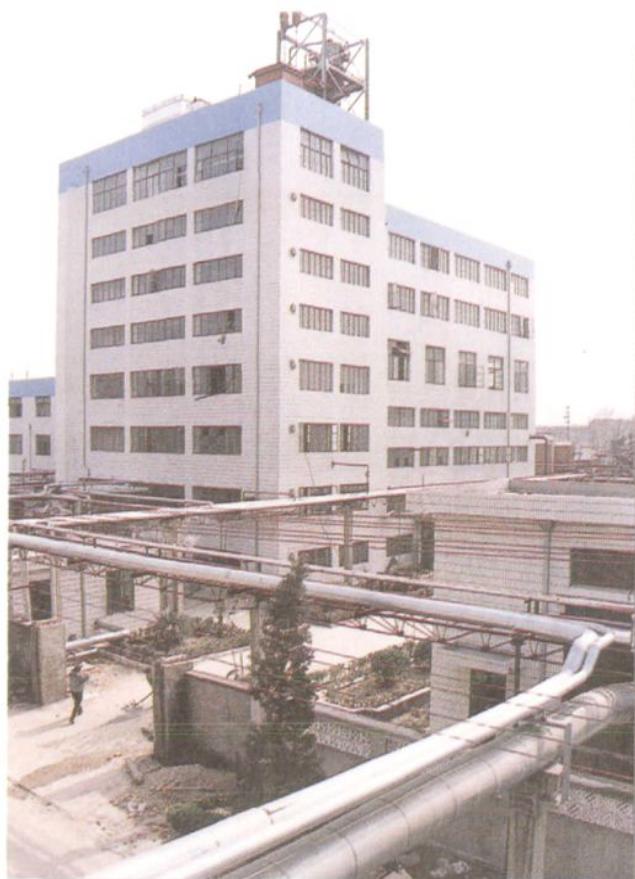
通向热用户的 供热蒸汽管道
