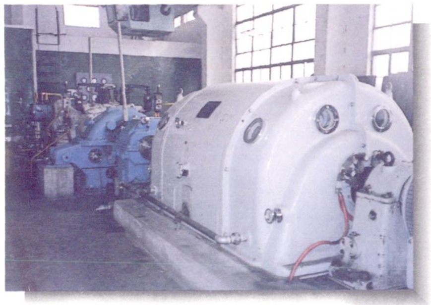
厂属淮阴市电建公司为扬州钢板纸厂安装的 1500 千瓦高速发电机组
