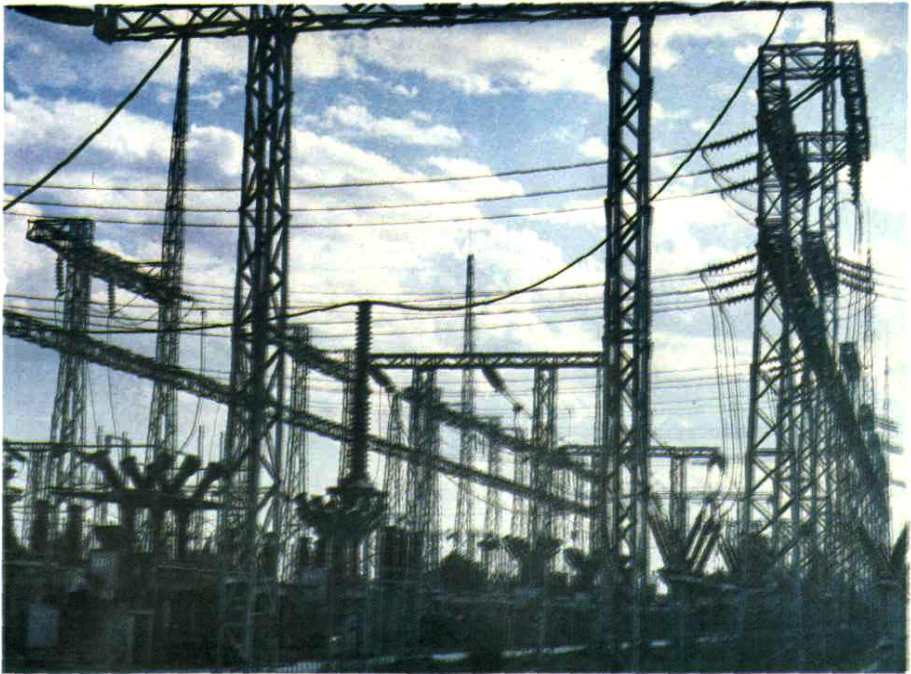
东郊变电站110千伏升压站 (技术科供稿)
