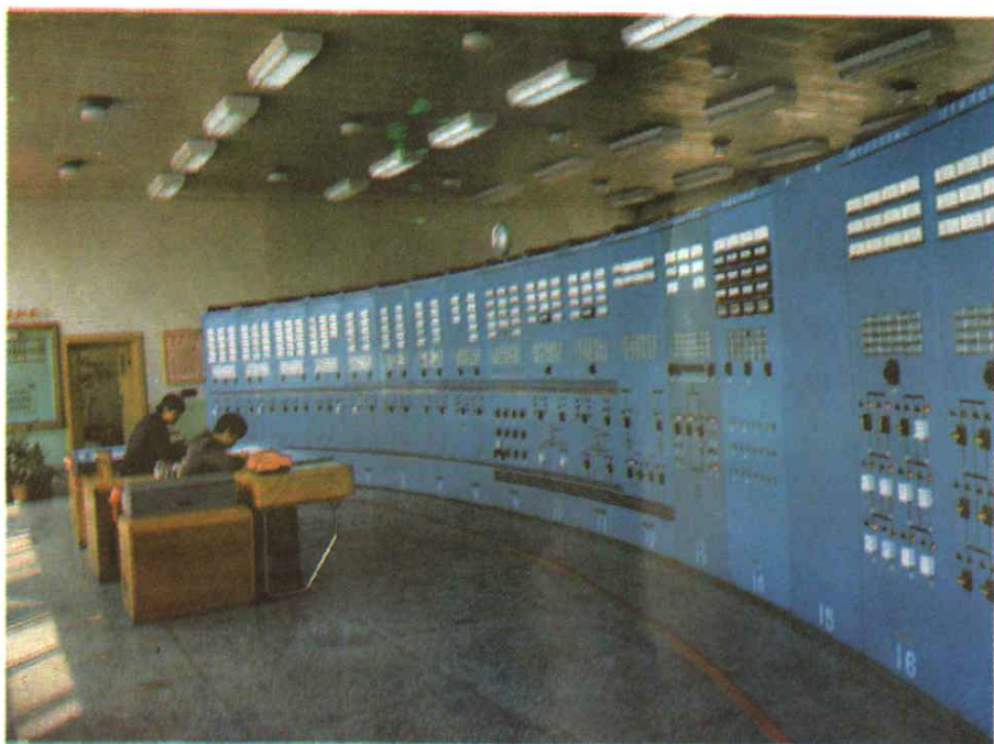
东郊变电站主控制室
