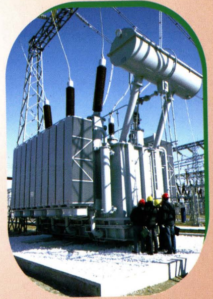
▲ 220千伏兴一变2#主变 投入运行 (2008.11.21)
