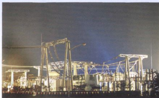
500 千伏瓶窑变电所
