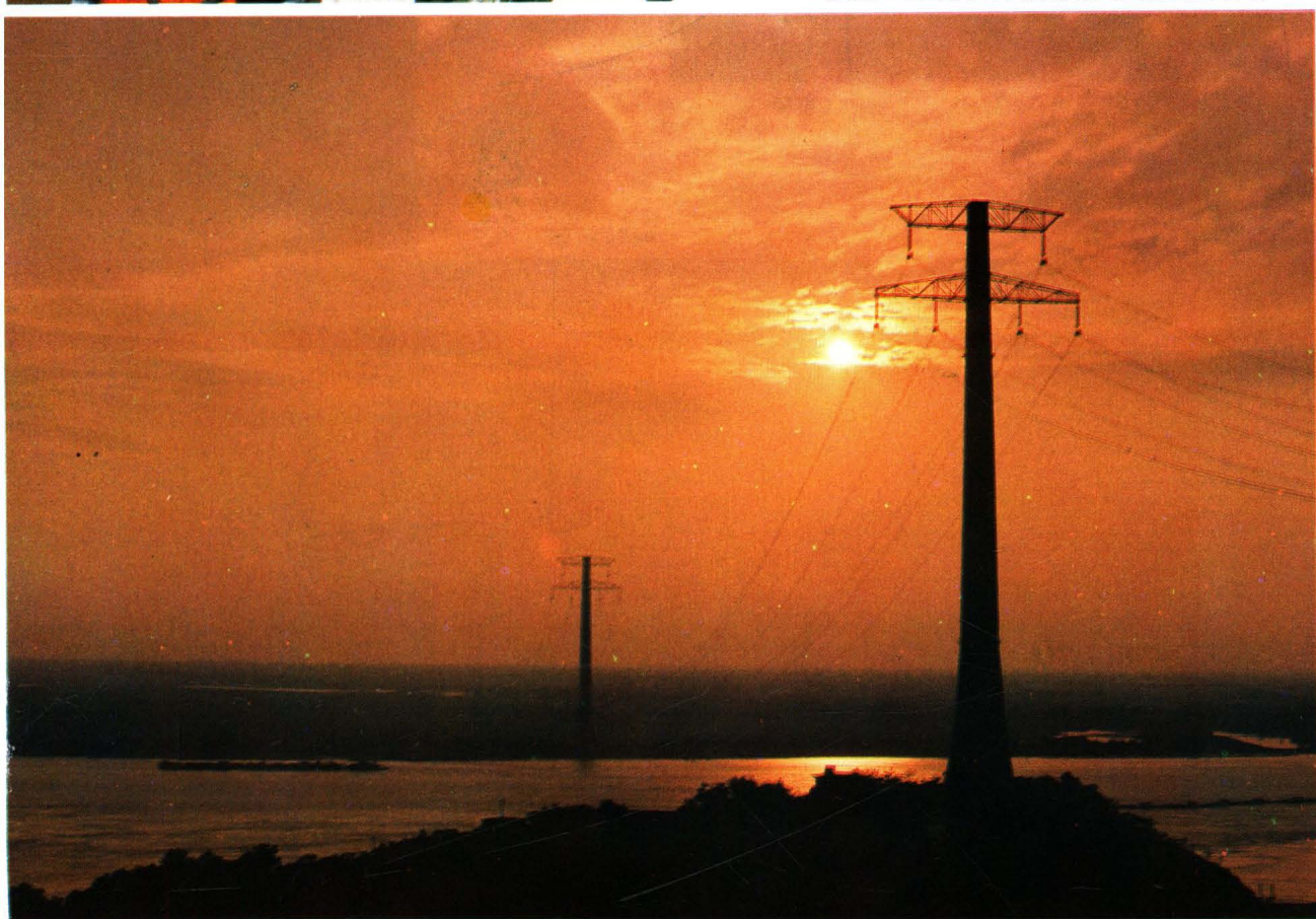
淮南—上海50万伏输变电线过江电塔
