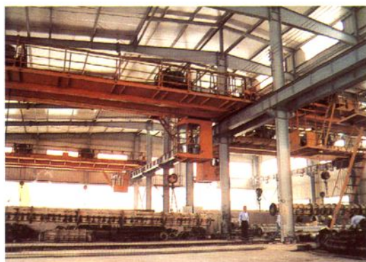
上海柘中混凝土制品有限公司生产车间
