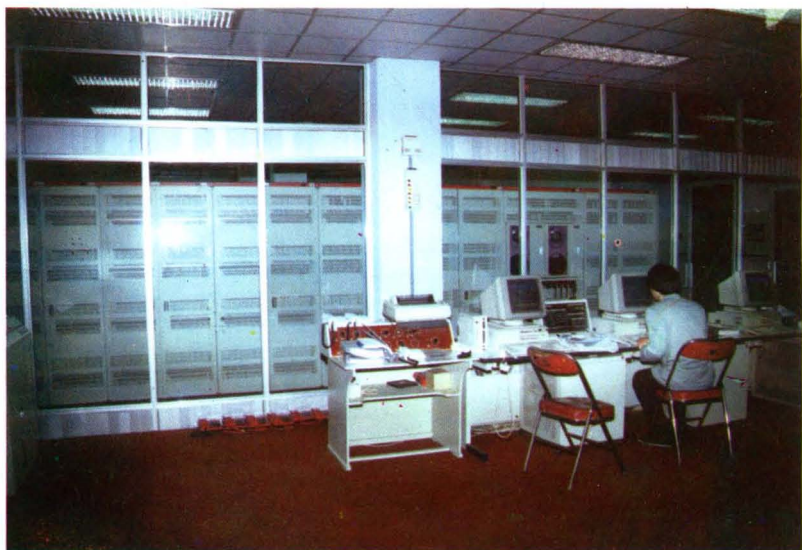
北辰区局程控交换机机房
