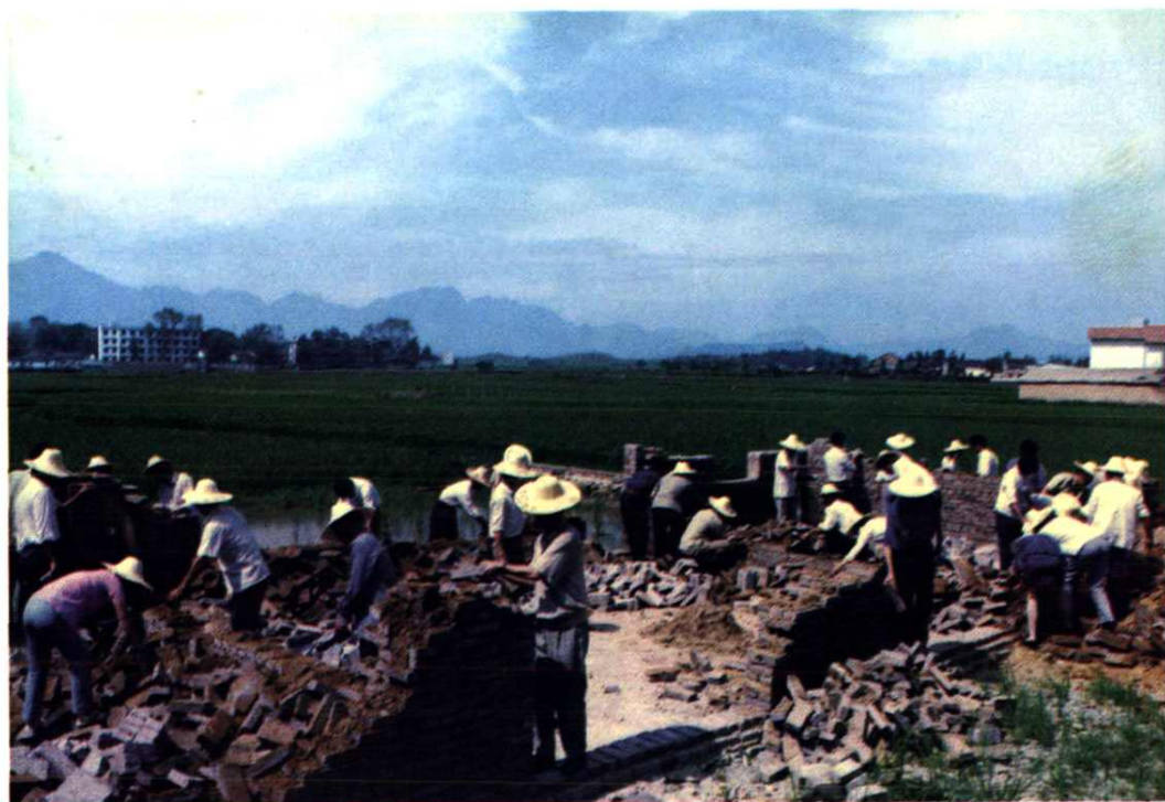
1990年6月建德县土地管理局对良田建房的违章建筑物拆除现场
