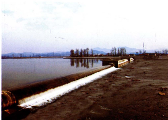
永陵镇橡胶坝
