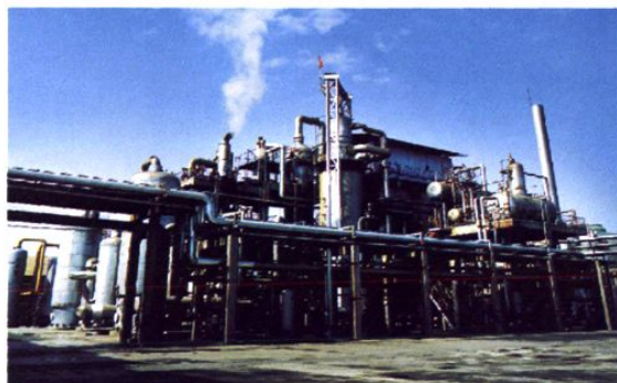
2006年5月，宏达集团德阳天然气化工生产基地年产10万吨合成氨直转系统
