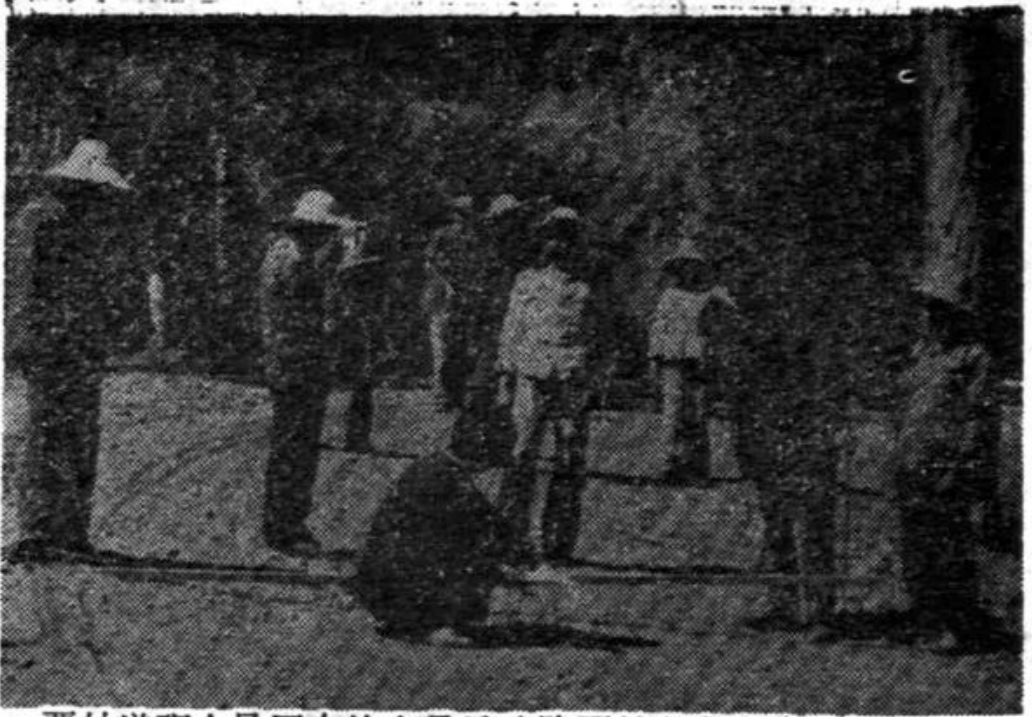
贾姑道班人员正在检查易峨公路贾姑段弯道路拱矢度 (易门公路管理段供稿)
