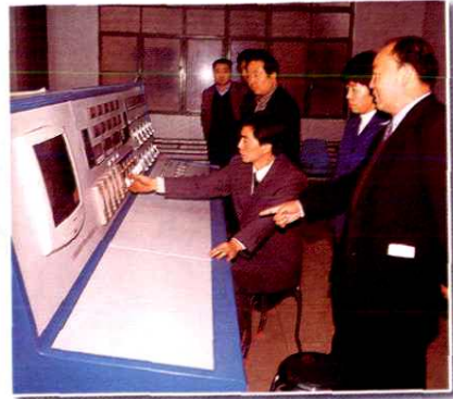
电厂生产主控室
