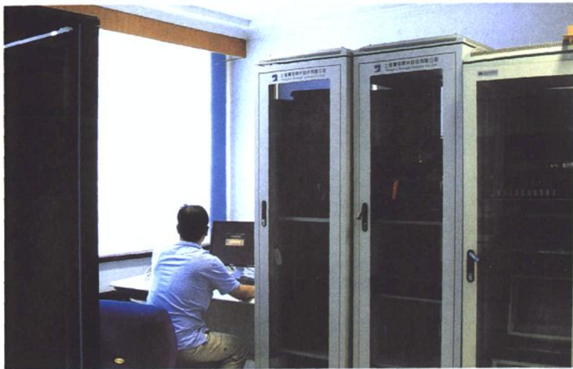
海盐县国土资源局 信息中心机房
