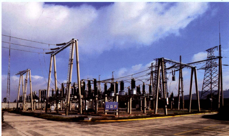
2005年12月11日，110千伏青龙变电站竣工投入运行
