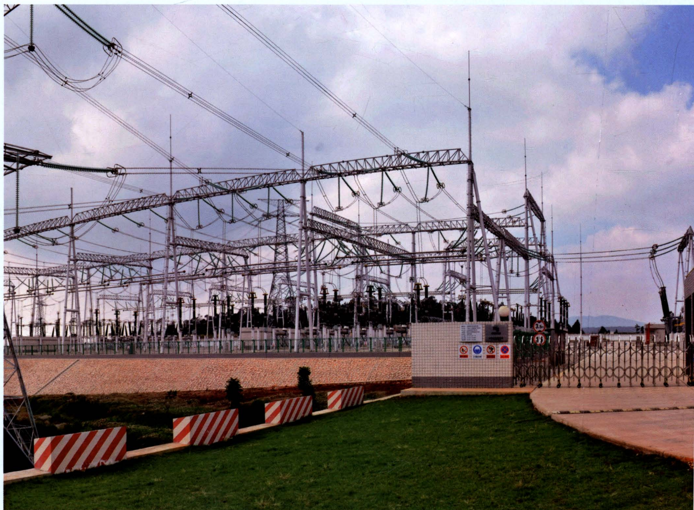
2013年5月25日，华宁境内首座500千伏变电站——500千伏宁州变电站一期工程竣工投入运行
