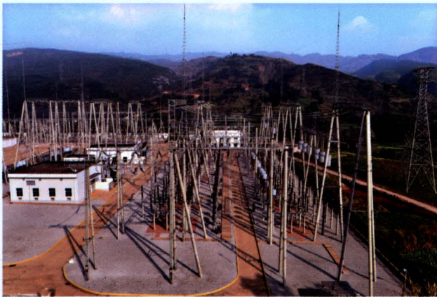
2010年5月29日，220千伏泉乡变电站一期工程竣工投入运行
