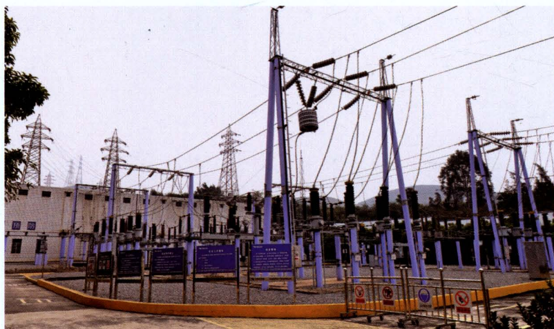
1998年12月8日，110千伏盘溪变电站一期工程竣工投入运行
