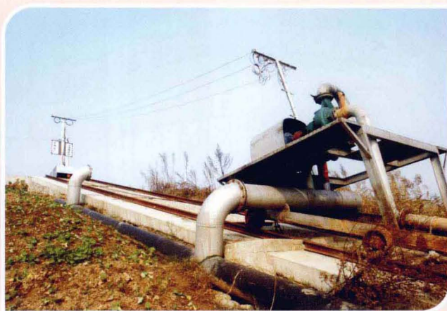
自来水厂北港移动抽水泵
