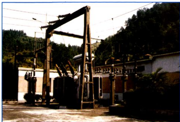
韶关电力局110千伏乐昌 变电站（1973年11月投产）
