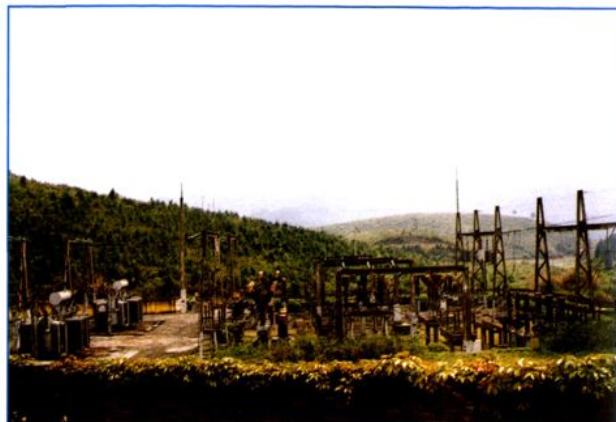
韶关电力局110千伏大岭 变电站（1972年12月投产）
