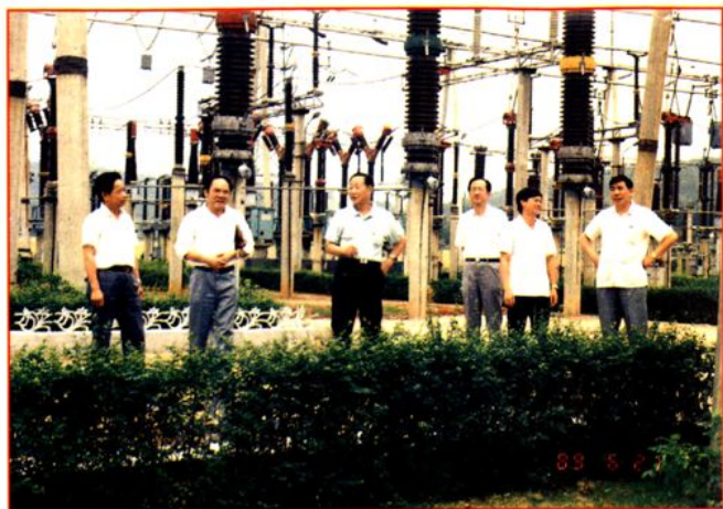
1989年6月，广东省电力工业局局长陈岗（左三）在韶关供电局220千伏芙蓉变电站检查工作
