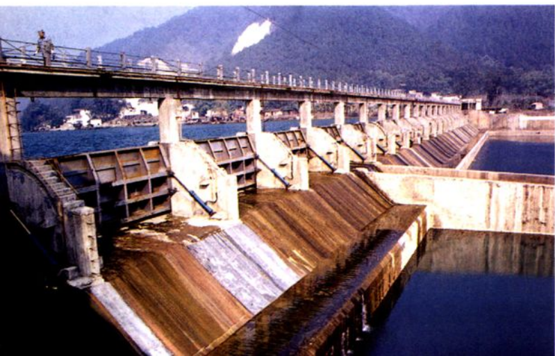
乐昌张滩水电站总装机 6010千瓦（1970年建成）
