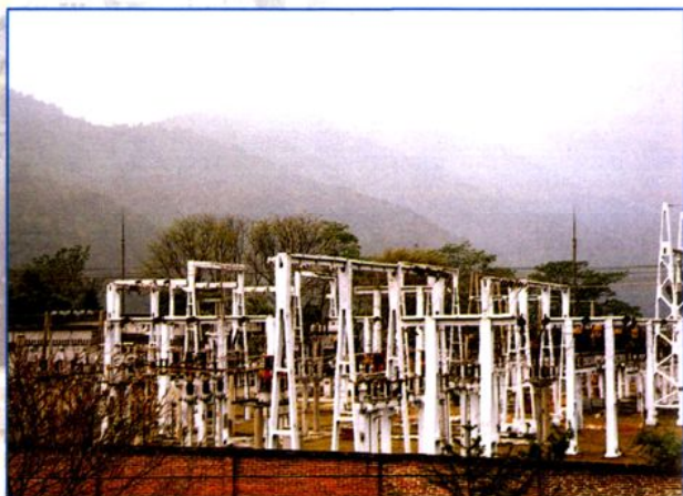
韶关电力局110千伏顿 岗变电站（1977年3月投产）
