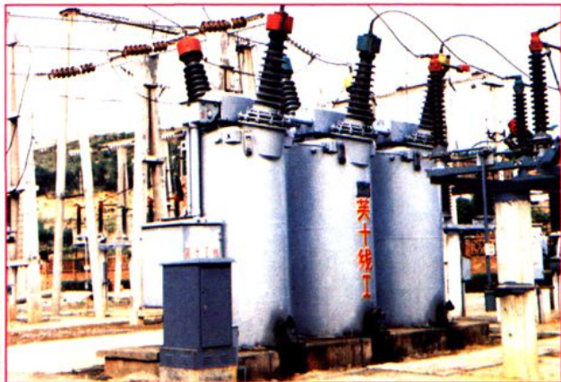
建于1960年的韶关第一座110千伏变电站十里亭站
