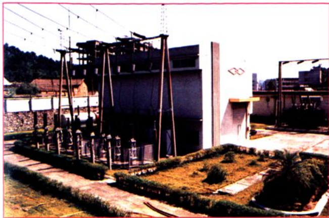
韶关地区第一座变电站河西站（1959年投运）
