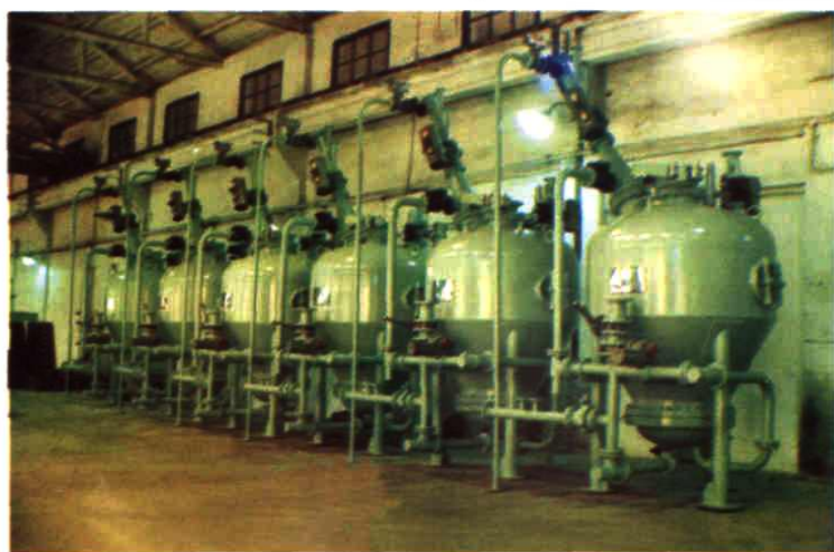
仓泵生产线一角
