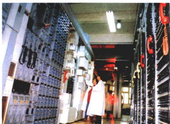
省电讯枢纽中心
