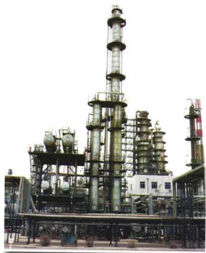
1.2万吨/年MTBE装置
