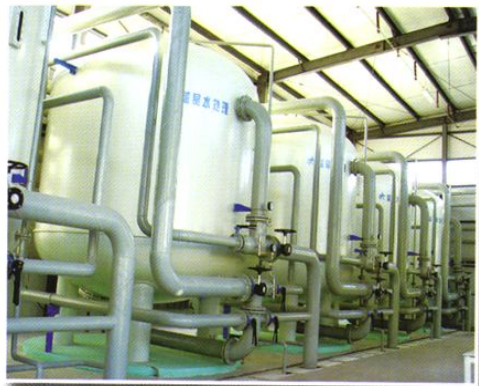
450立方米/小时污水回用装置
