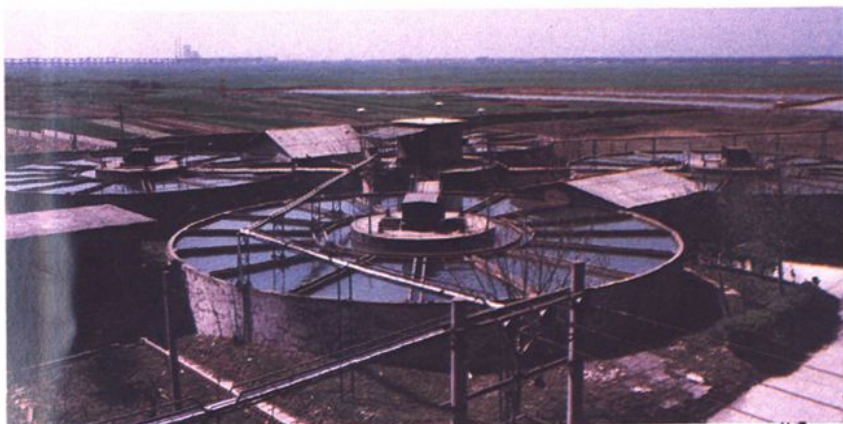
供水快速沉淀池
